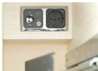
Voorinstallatie met steun voor TV uitgerust met één of meerdere stekkers.
